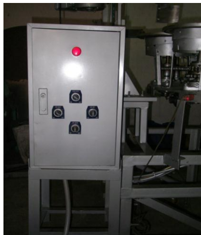
Hình 3.35 : Tủ điện điều khiển
